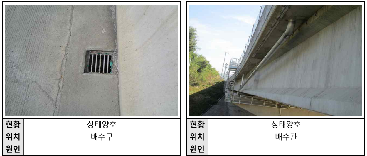
[표 11.3.4] 배수시설 손상현황
